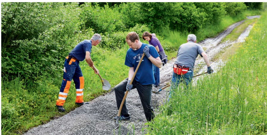
Eine weitere Gruppe setzt einen Wanderweg der Gemeinde wieder instand und verteilt dafür rund 25 LKW-Ladungen Kies.
